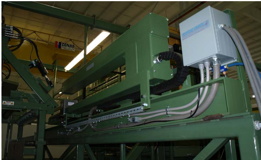
Medidor de Espesor Instalado en una Línea de Decapado EPS de 74" de Ancho
